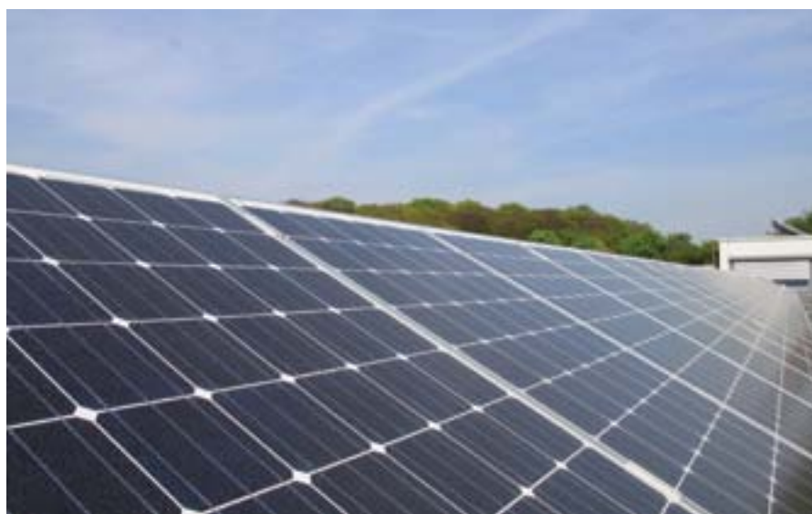
Stromversorgung mittels eigener Photovoltaik Anlage.
